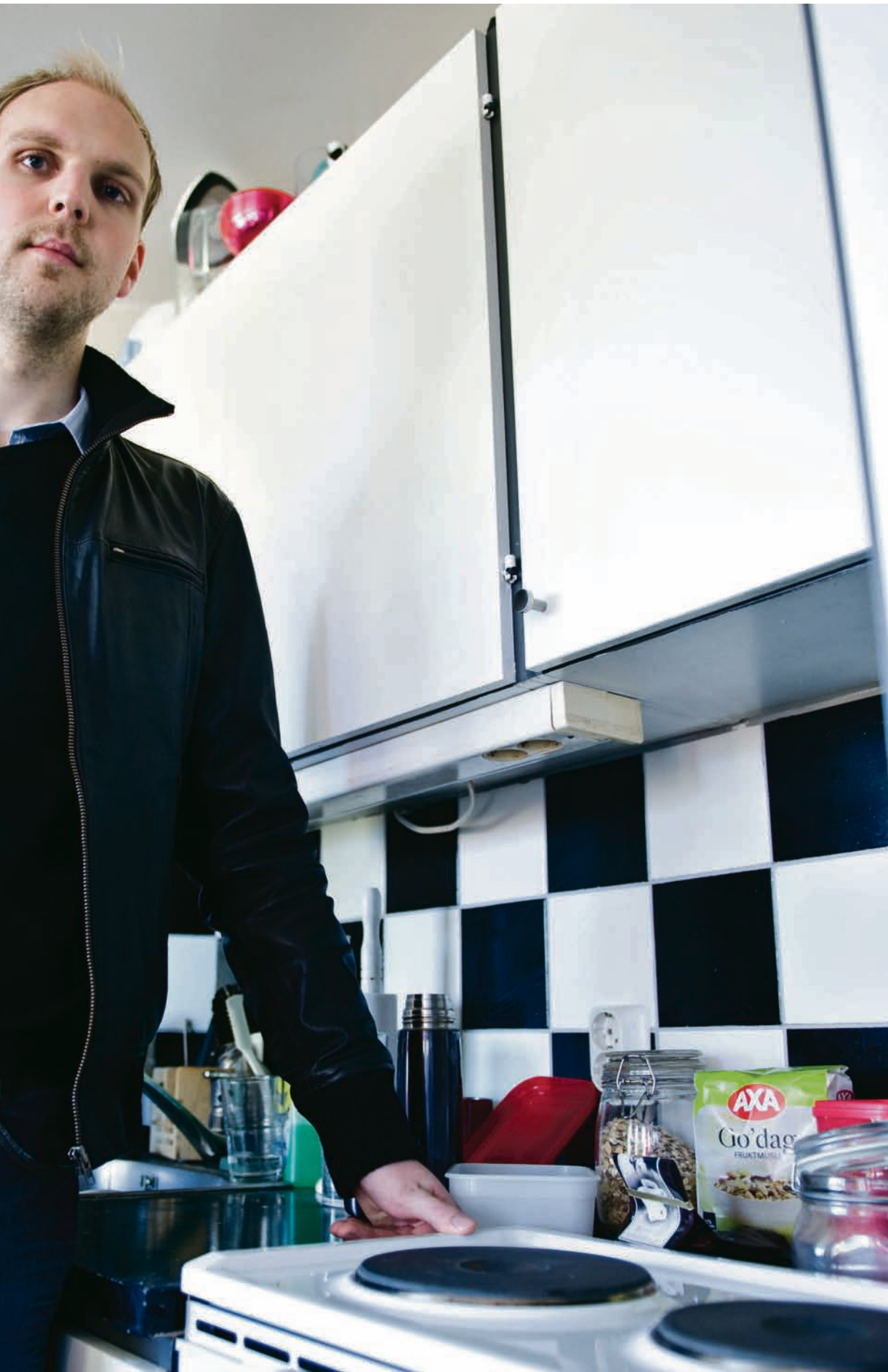
SiO mener kjøkkenet hans har et ventilasjonsanlegg. – Det er en ventil oppe på veggen, men det er ikke noe trekk der, sier Hjorthen.
