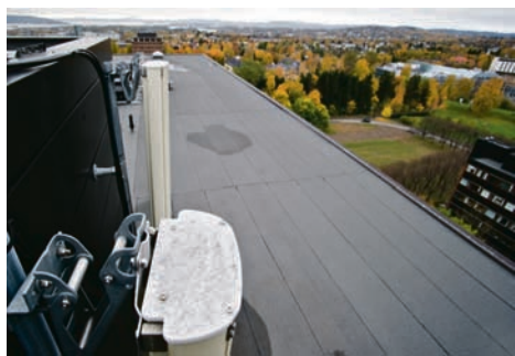
Antenner til besvær: Disse mobilantennene tilhører Telenor og NetCom og står på taket til Universitetet i Oslo. Universitetet har strittet imot monteringen av enda en antenne, men ble i denne måneden presset av Kunnskapsdepartementet til å gi seg i saken.
