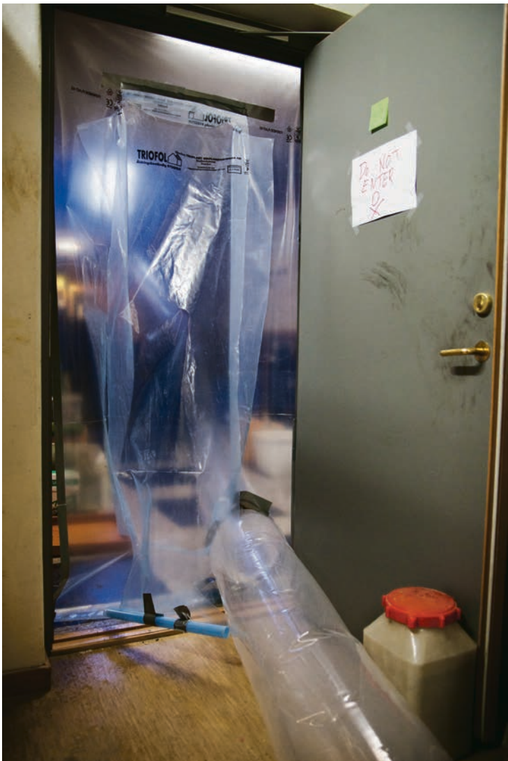
«Do not enter»: Det var på dette kjølerommet giftlekkasjen oppstod forrige tirsdag. Området er fremdeles sperret av, og lufta renses for kjemikalier.
