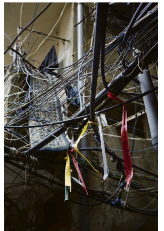
Strøm: Når regnet drypper ned fra de mange kablene, risikerer man livsfarlige støt.
