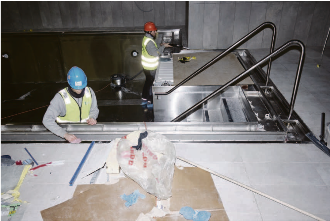
Spa: Et av premissene for prosjektet er at det skal være hjem for livet. Dermed har de fremtidige beboerne tilgang til en rekke fasiliteter i første etasje av bygget. Blant annet svømmebasseng.
